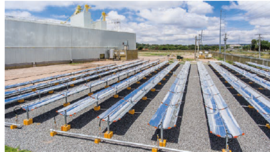
Parabolrinnenkollektoren bei Comercial Forrajera de Lagos (COMFOSA) in Mexiko. Foto: COMFOSA
